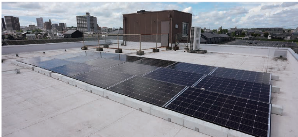
屋上に設置された太陽光パネル
